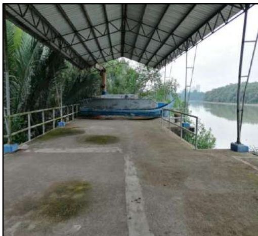
Keadaan Jeti PPM W2 Yang Tidak Dapat Digunakan PPM Wilayah 2, Tampoi, Johor (28.09.2020)
