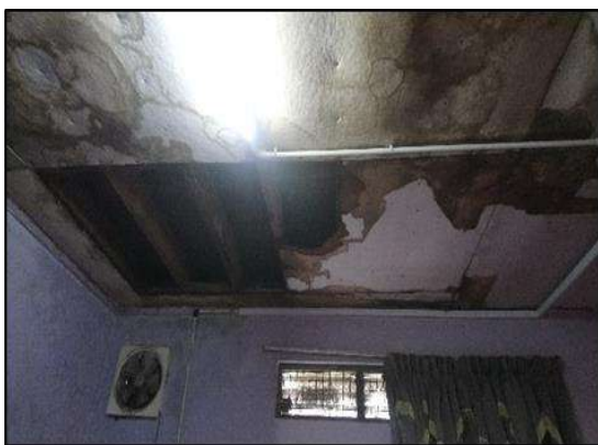
Siling Bilik Rosak Rumah Perantaraan WP Kuala Lumpur (23.10.2019)
