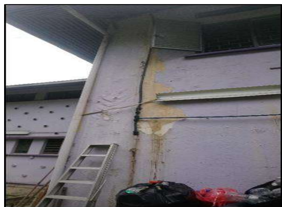
Dinding Rosak Akibat Kebocoran Paip Rumah Perantaraan WP Kuala Lumpur (23.10.2019)
