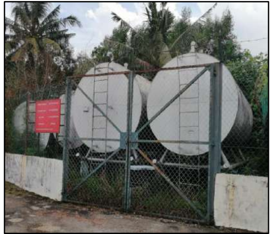
Skid Tank Tidak Dapat Digunakan PPM Wilayah 2, Tampoi, Johor (28.09.2020)
