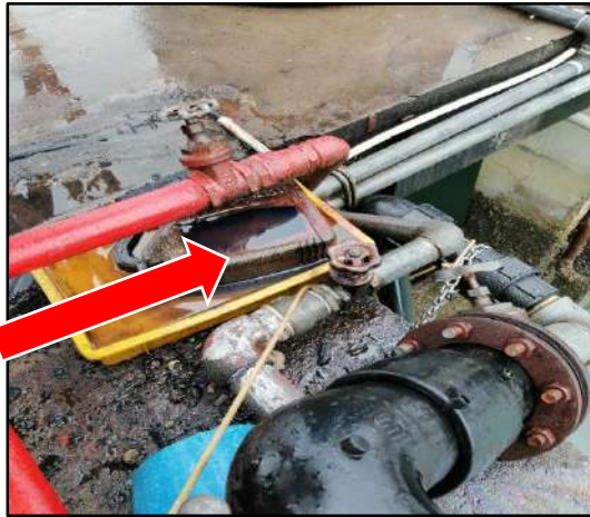
Saluran Paip Minyak Petrol Dan Diesel Bocor Markas Operasi Langkawi, Kedah (25.06.2020)
