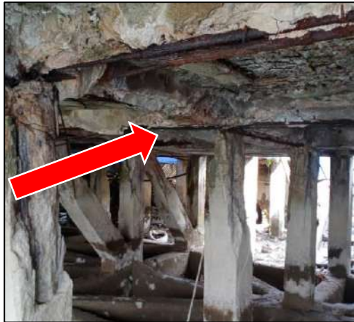
Struktur Tiang Yang Rosak Dan Berkarat Markas Operasi Muar, Johor (30.09.2020)
